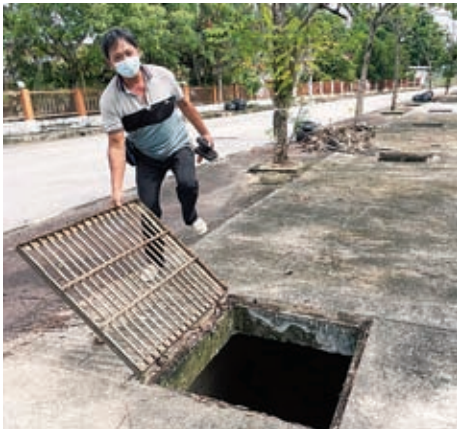
陈助顺:珍珠城铁沟盖被偷走逾 150 个,留下让人触目惊心的深洞,危及路人的安全!
